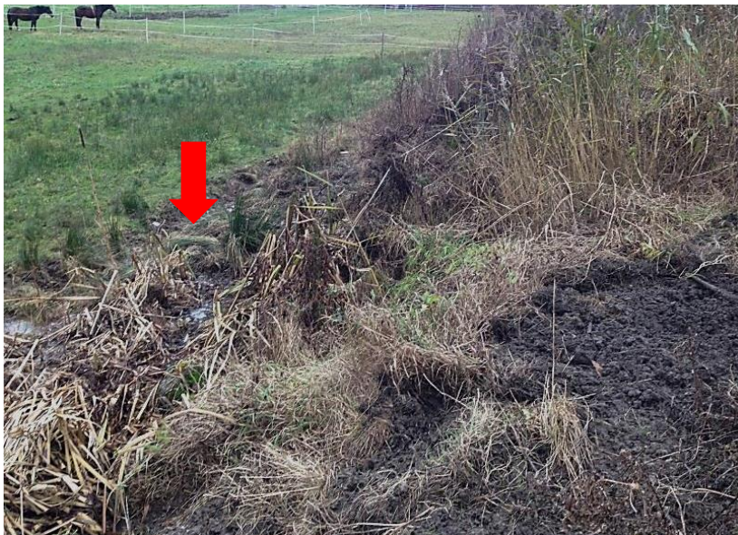
Utläckage av avloppsvatten.
