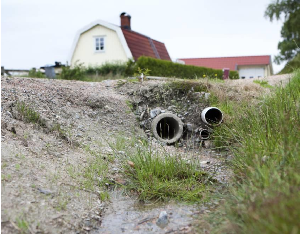
Avloppsrör under väg ut i dike. Foto: Kristin Nylander/HaV.
