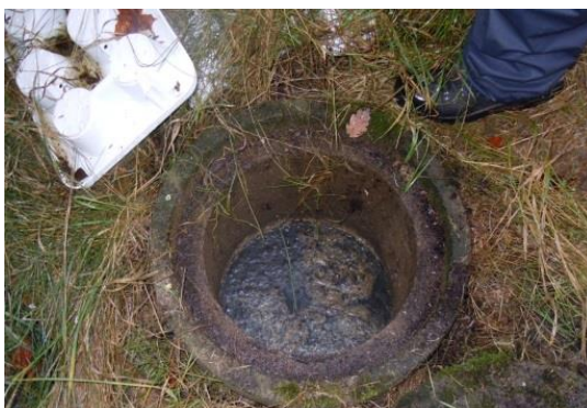
Enkammarbrunn för BDT. Jordarten är genomsläpplig runt enkammarbrunnen. Ingen dokumentation överhuvudtaget finns på BDT-avloppet.
