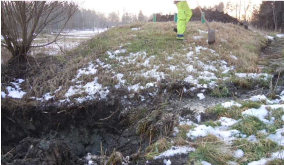
Upphöjd infiltration, tillståndsgiven och slutbesiktigad 2004.
