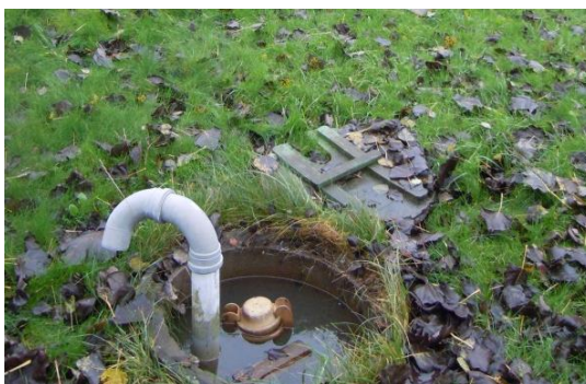
Sluten tank där det står vatten runt tömningsröret.
