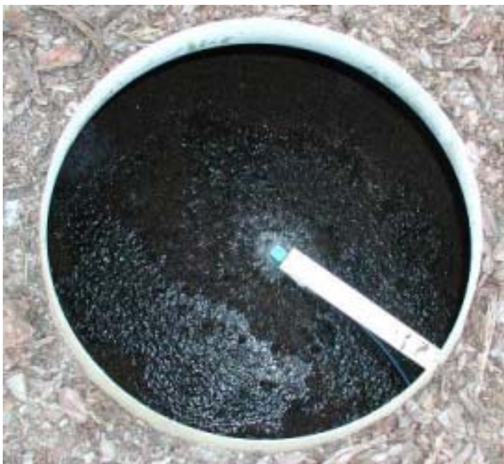
Figur 11. Dysa för spridning av avloppsvattnet över sprayfilter.
