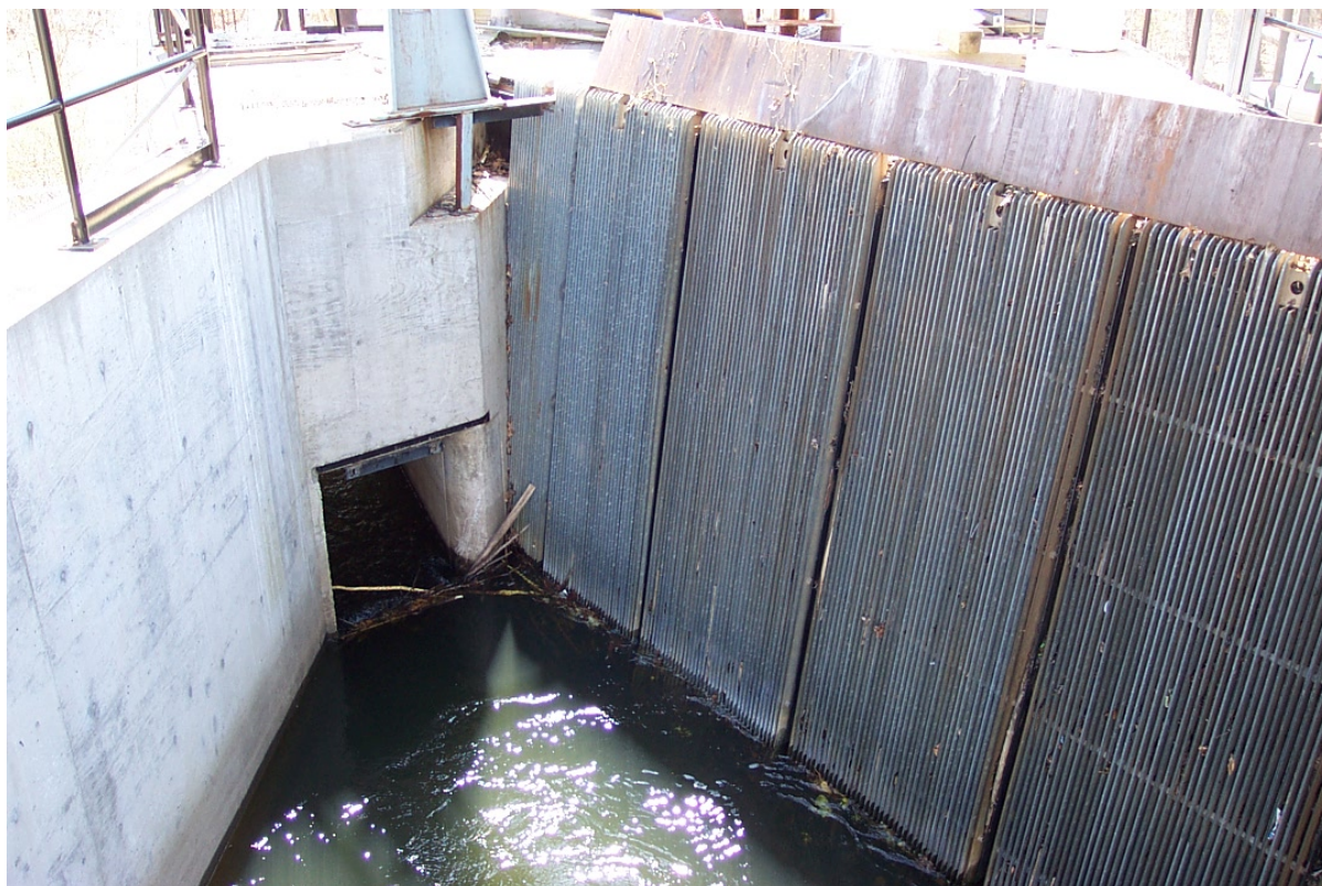
Figur 15. Vinklat smalspaltigt galler (angled bar rack-course louver). Öppningen i betongväggen är ingången till fiskens förbipassage.
