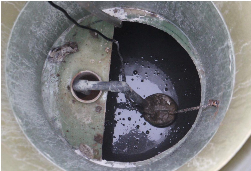
Bild 4 Så här ser anläggningen ut när det inte fungerar bra, grumligt vatten, slam på väggar.
