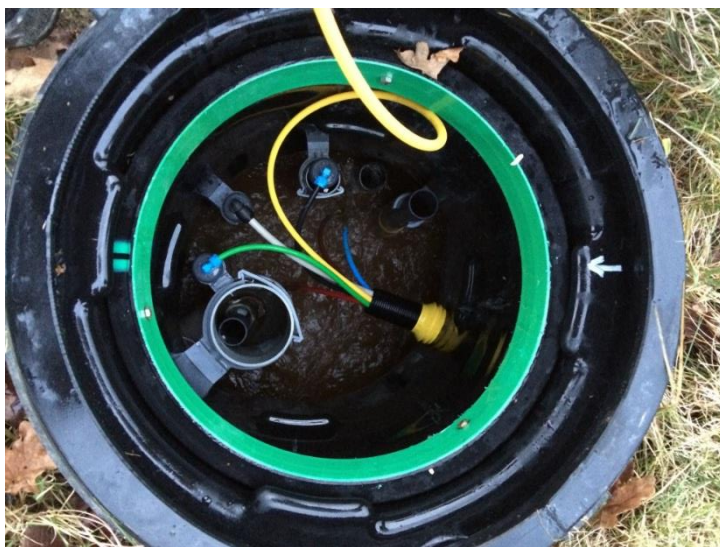
Så här ser anläggningen ut när det fungerar bra
