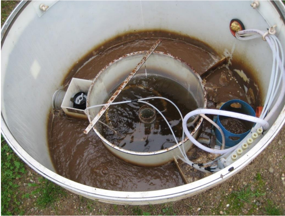
Så här ser anläggningen ut när den fungerar bra och luftningen är igång.
