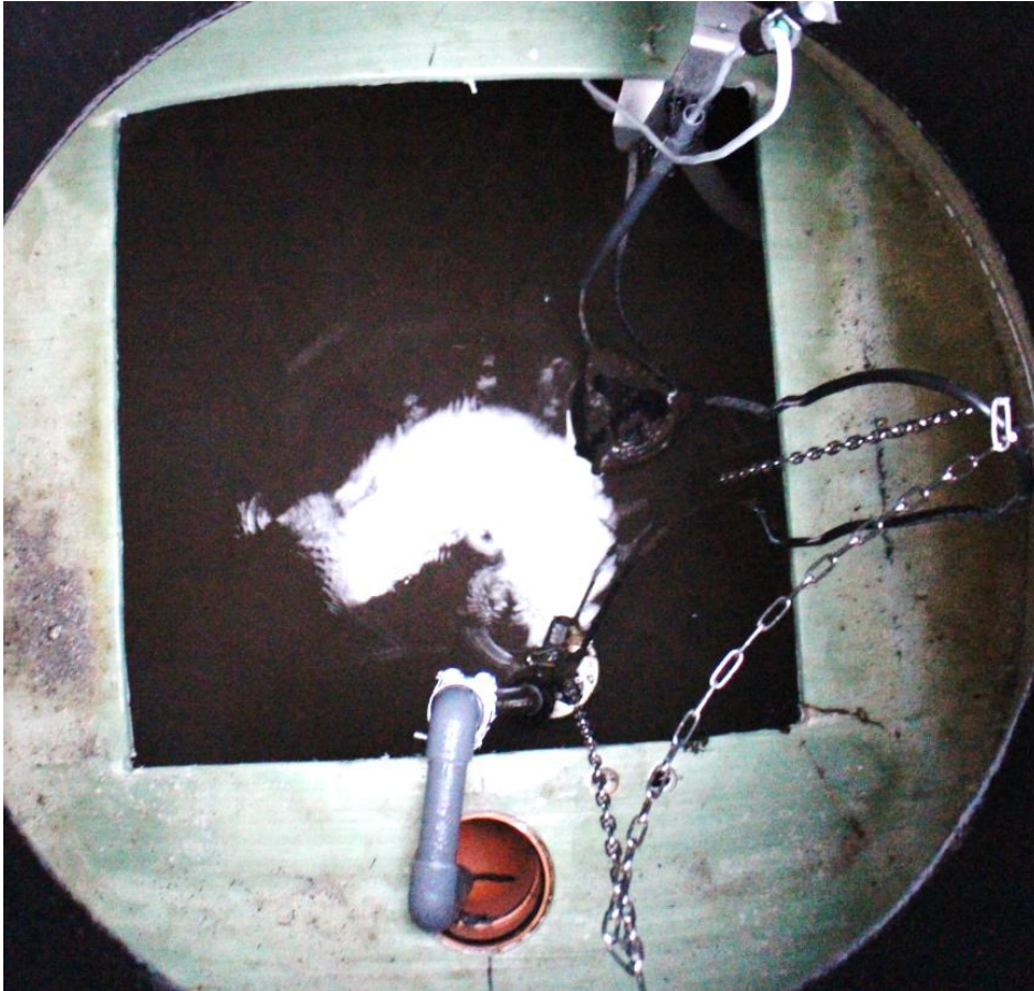
Bild 2 Så här ser anläggningen ut när det fungerar bra
