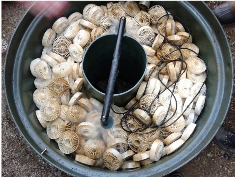
Så här ser anläggningen ut när det fungerar bra
