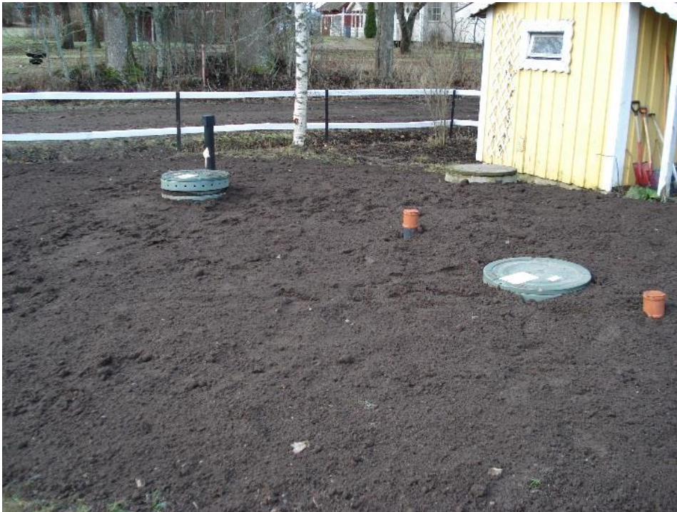
Figur 1: Slamavskiljare med två inspektionsrör, följt av biobädd med luftningsrör och fläkthus med lufthål. I fläkthuset finns fläkten och provtagningsröret.
