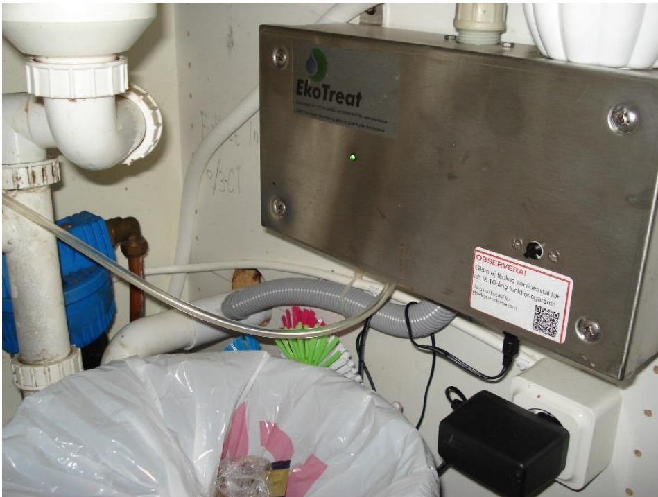
Figur 2: EkoTreat fällningsenhet. Den grå doseringslangen har självfall och ansluter till avloppet först efter vattenlåset. Funktionslampan lyser grönt.
