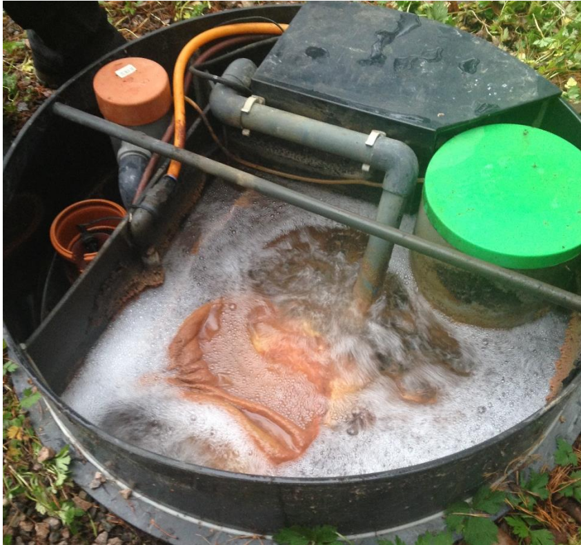
Så här ser anläggningen ut när det fungerar bra
