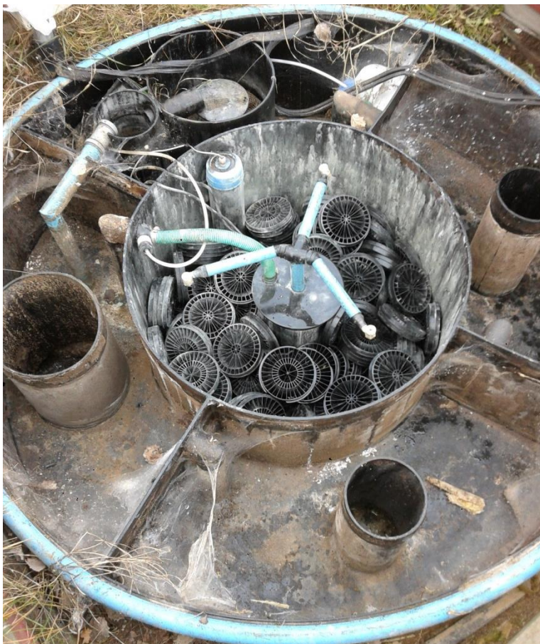
Så här ser anläggningen ut när det inte fungerar bra
