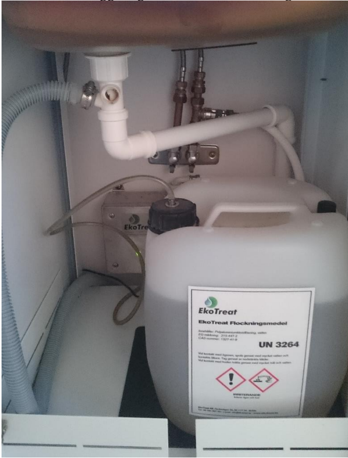
Figur 3: Felaktig installation av fällningsenheten. Den grå doseringsslangen ansluter till avloppet högre upp i förhållande till fällningsenheten, självfall saknas. Risk för att fällningskemikalie sätter igen slangen över tid.
