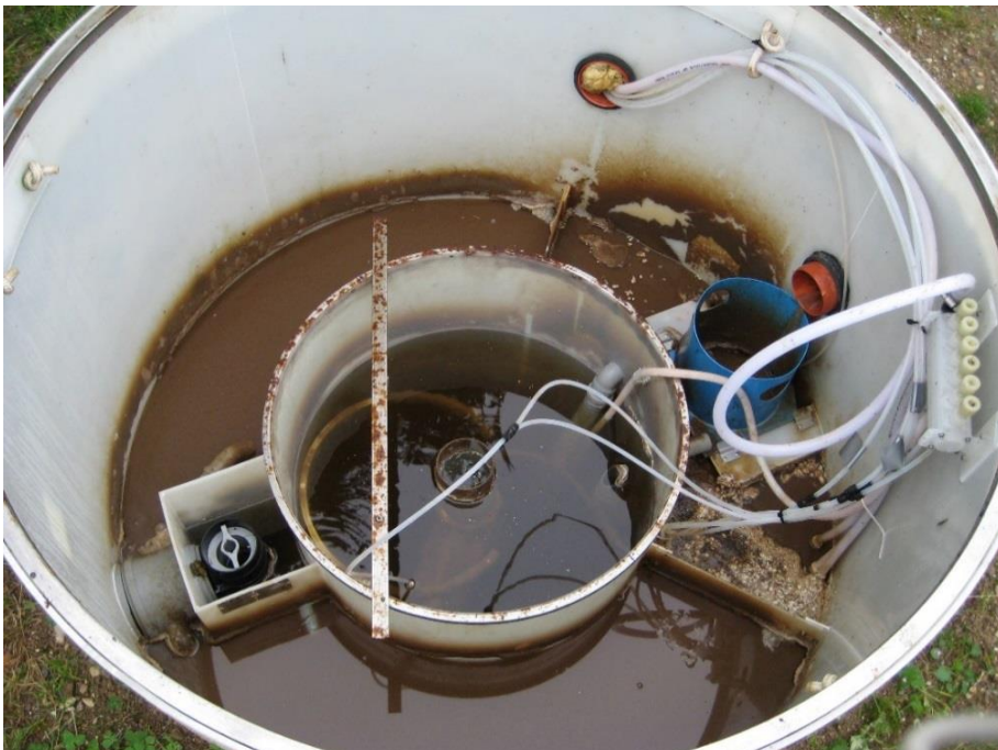
Så här ser anläggningen ut när den fungerar bra och luftningen inte är igång.
