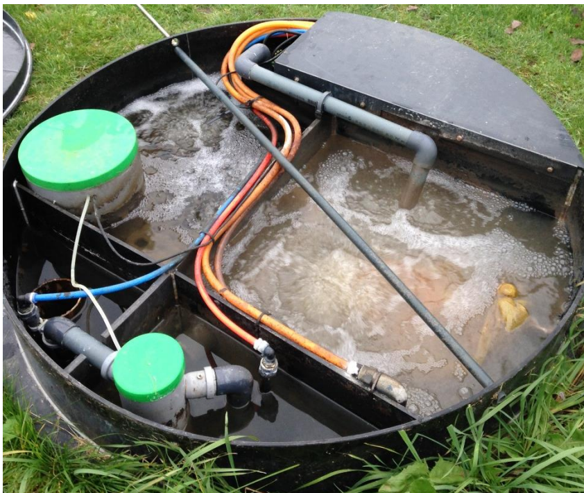
Så här ser anläggningen ut när det inte fungerar bra
