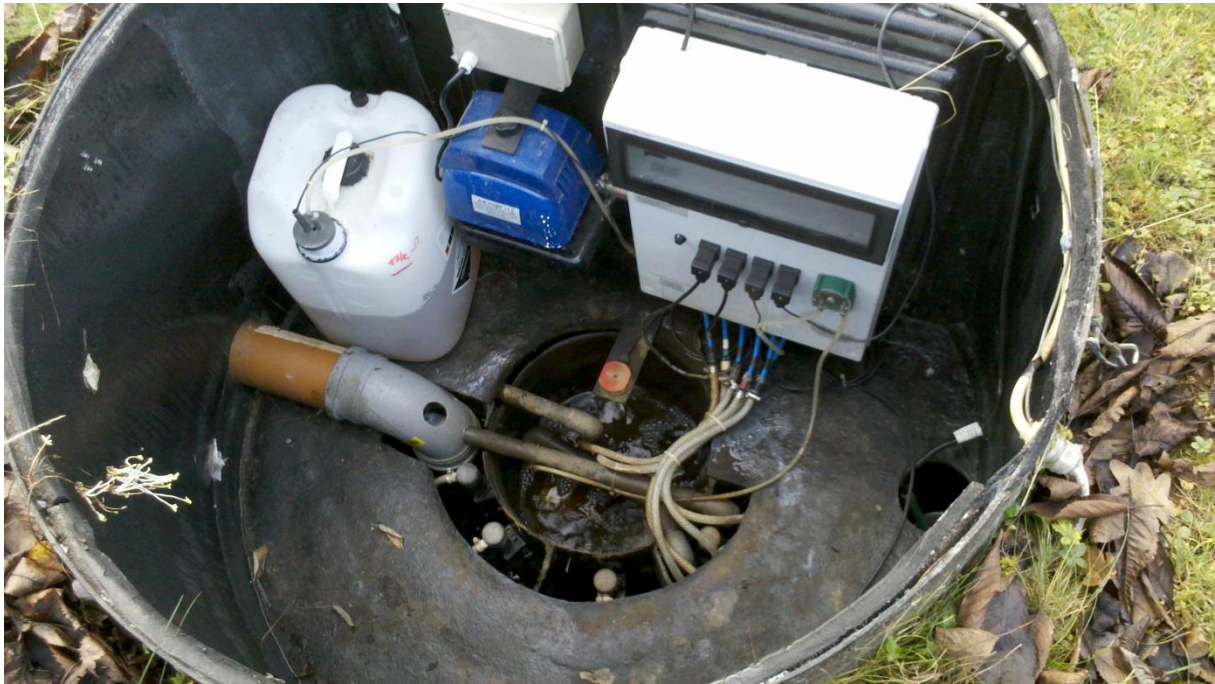
Så här ser anläggningen ut när den fungerar bra
