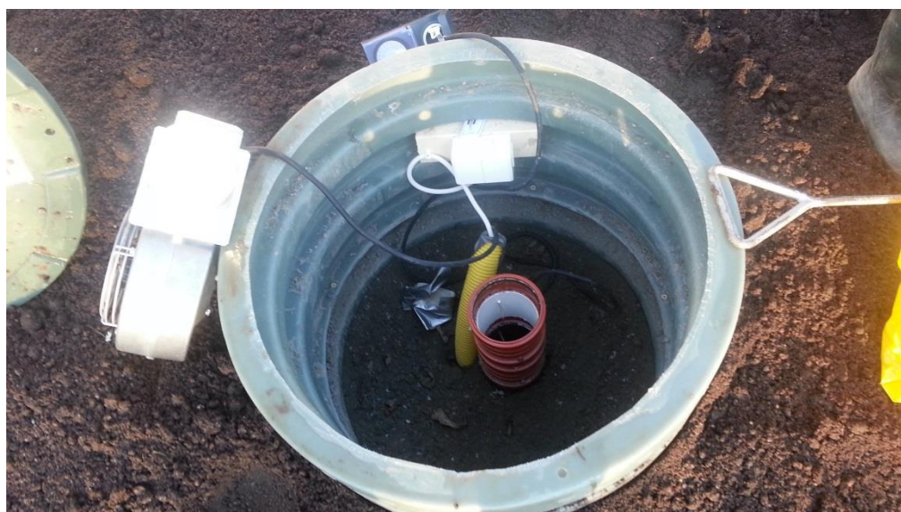
Figur 3: Efter att fläkten lyfts bort kan provtagning ske via provtagningsröret i fläkthuset.
