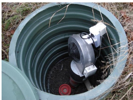
Figur 1: Fläkthuset med fläkt, timer och elanslutning.
