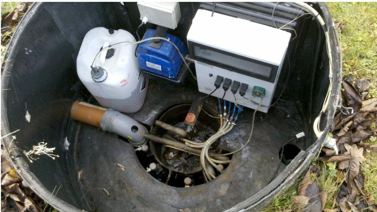
Inlopp (orange/grått rör), kemdunk ,styrenhet, i mitten själva verket samt till höger provtagningshål.
