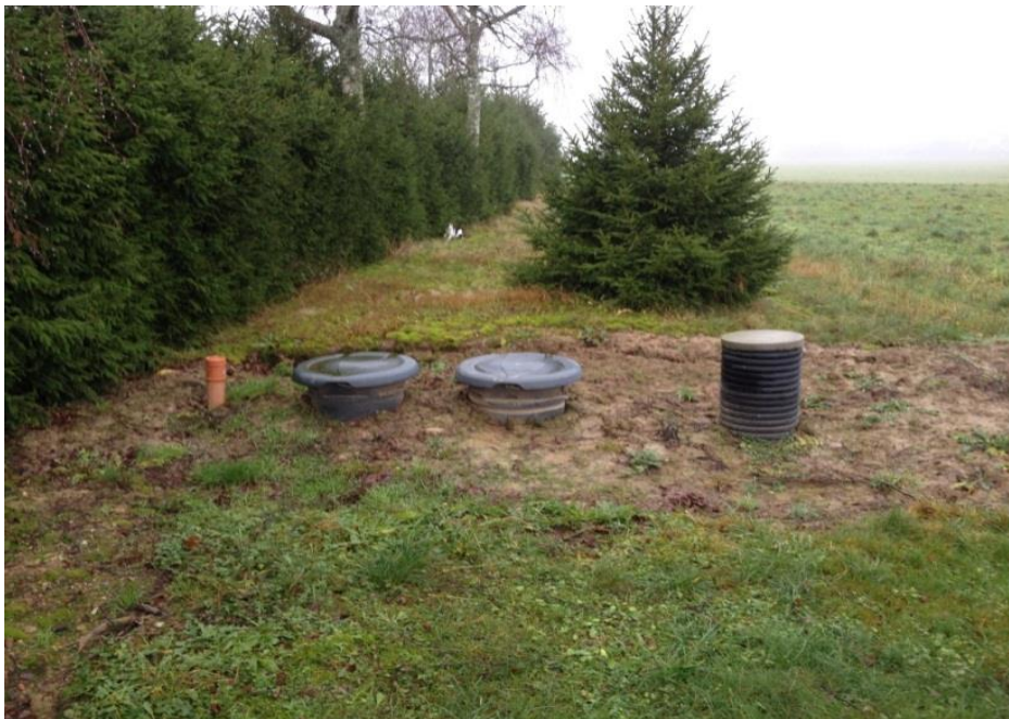
Installerat verk med provtagningsbrunn
