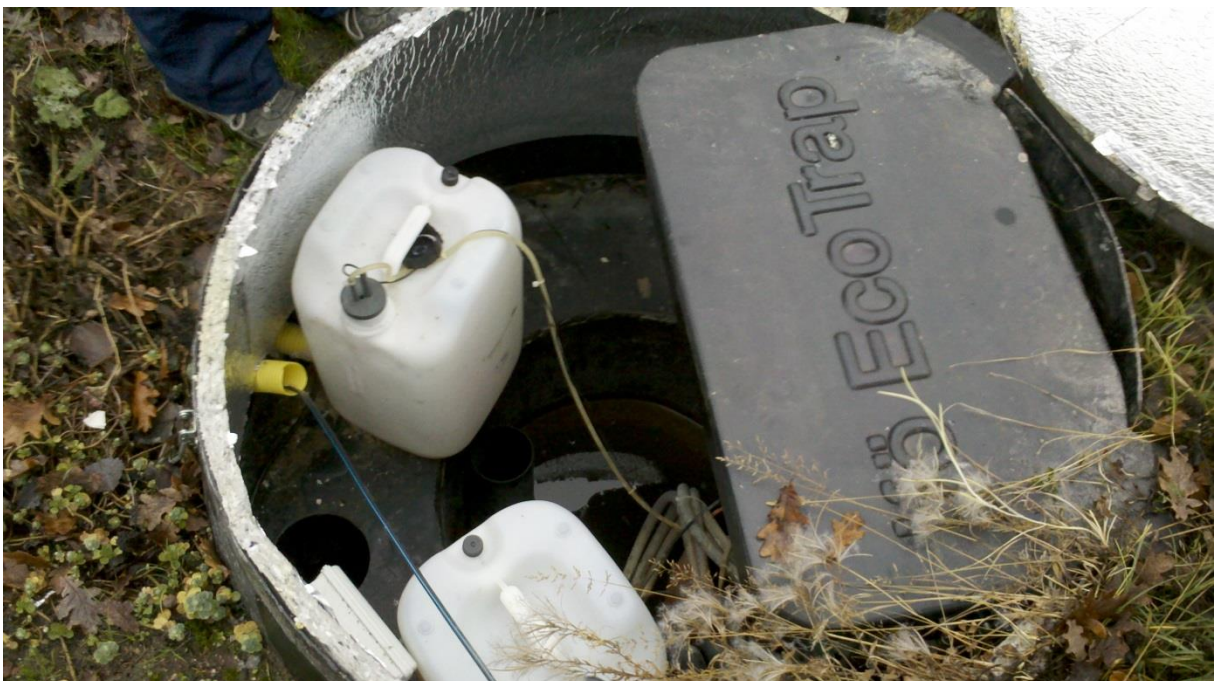
Kemdunkar, provtagningshål, själva verket samt styrenhet i lådan.
