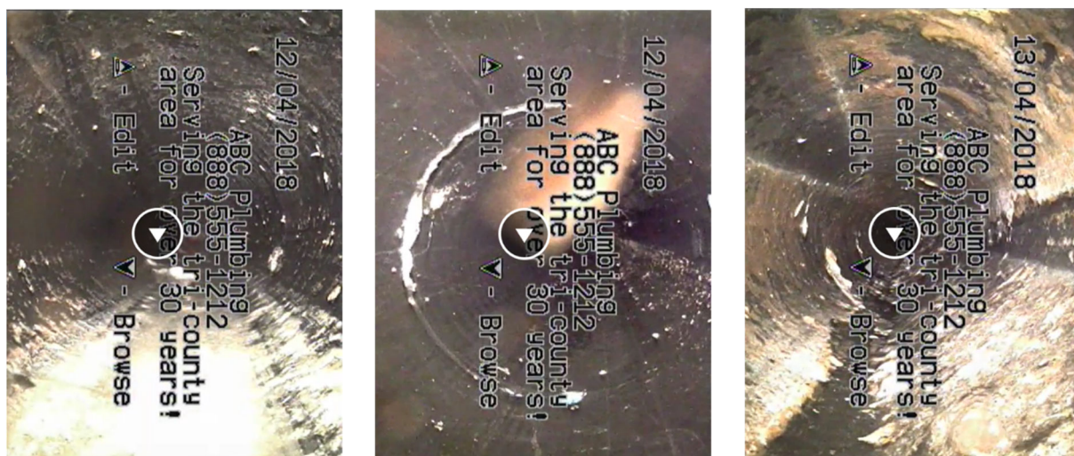
Figur 5 Exempel på bilder som erhöles vid kamerainspektion av spridarledningarna. Till vänster syns en ledningsträcka med stående vatten (anläggning D), i mitten en torr ledningssträcka (anläggning D) och till höger en ledning med både vatten och slam-partiklar (anläggning A).
