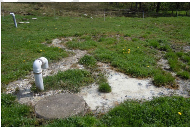
Figur 17 Markbaserad anläggning där avloppsvattnet tränger upp till ytan. Foto: Kungsbacka kommun
