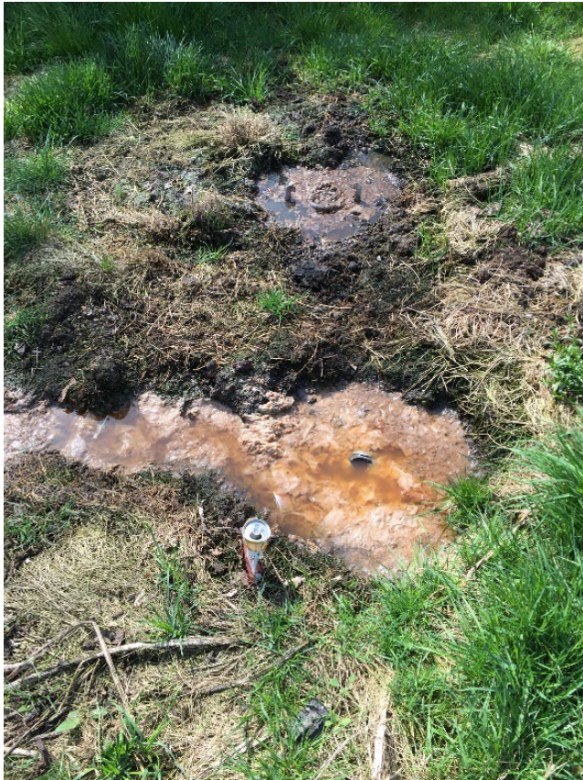
Figur 16 Exempel på anläggning med bristande skötsel – slamsugning har uteblivit och den slutna tanken har svämmat över. Foto: Kungsbacka kommun
