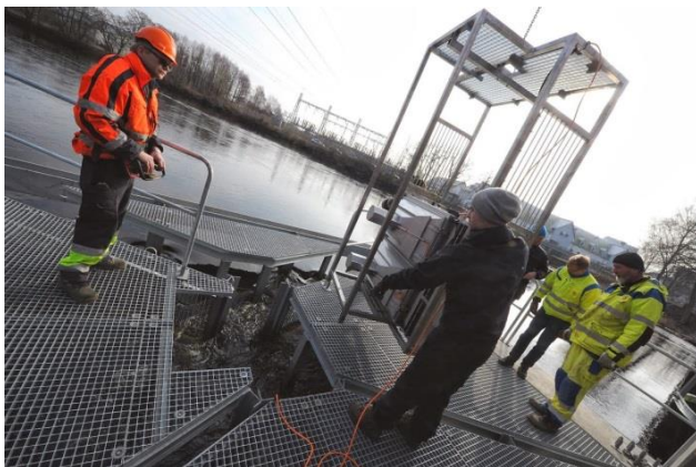
Bild 15. Installation av automatisk fiskräknare
