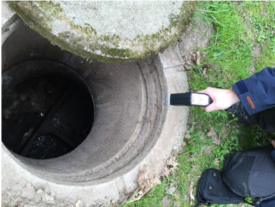
Bild 12 Temperaturmätning i slamavskiljare
