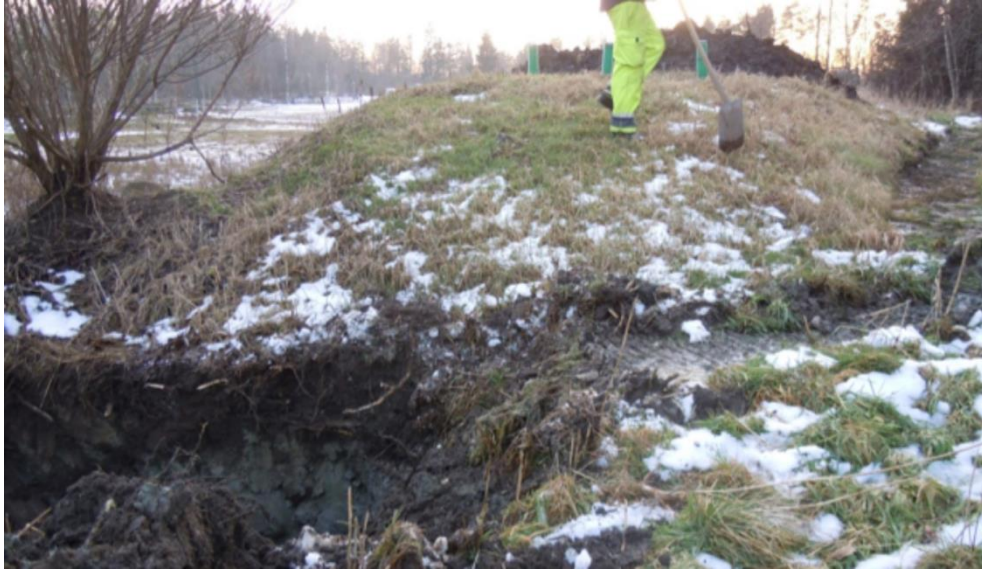
Upphöjd infiltration, tillståndsgiven och slutbesiktigad 2004.
