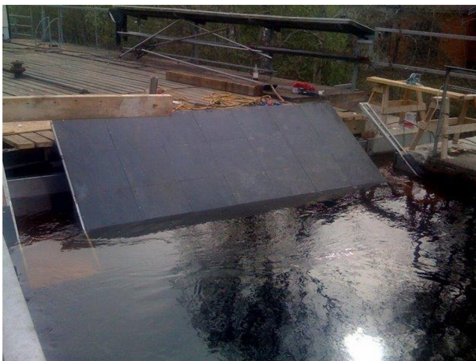
Figur 6. Överdelen av ett alfa-galler som består av en solid platta som skapar en strömrefug för fisk. Flödet regleras nedströms flyktöppningarna genom en reglerbar tröskel. Foto: Fiskevårdsteknik
