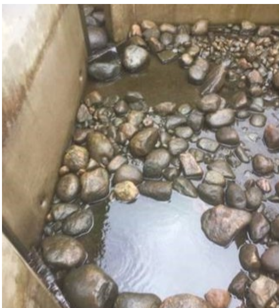
Figur 22. Slitsränna där bottenmaterialet till viss del spolats bort. Foto: Fredrik Nilsson, Länsstyrelsen Västra Götalands län.
