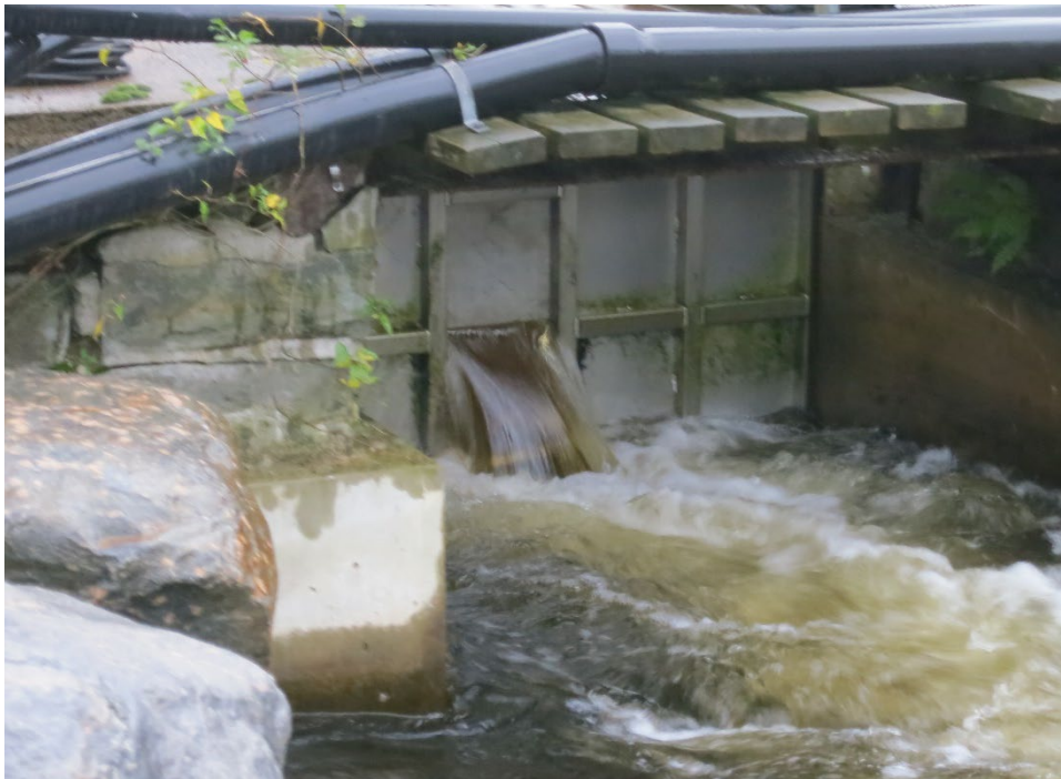
Figur 7. En lucka i omlöp som används vid reglering leder till höga vattenhastigheter som kan vara svåra att passera för svagsimmande arter. Bilden är tagen från nedströmssidan. Foto: Fiskevårdsteknik.
