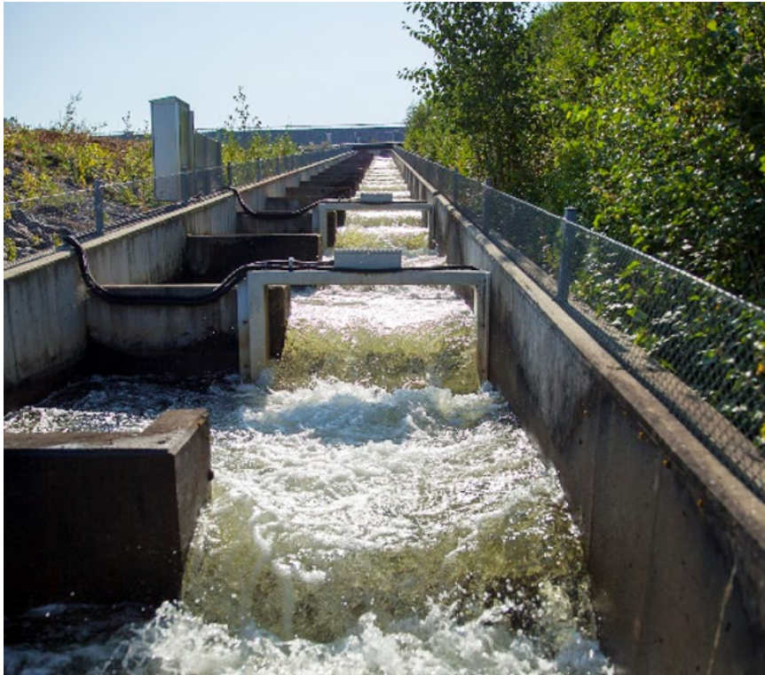
Figur 12. Bassängtrappa utrustad med PIT-tagantennar för registrering av återvandrande märkt lax och öring. Foto: Linda Vikström.
