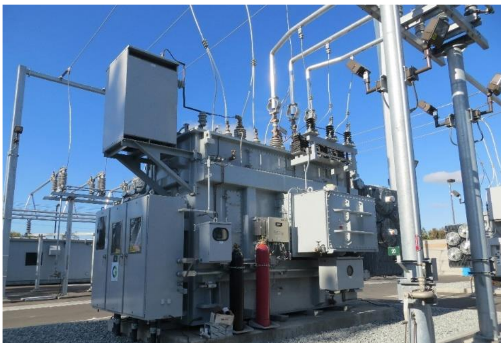
Figur 4: En transformator (Foto av American Public Power Association ).
