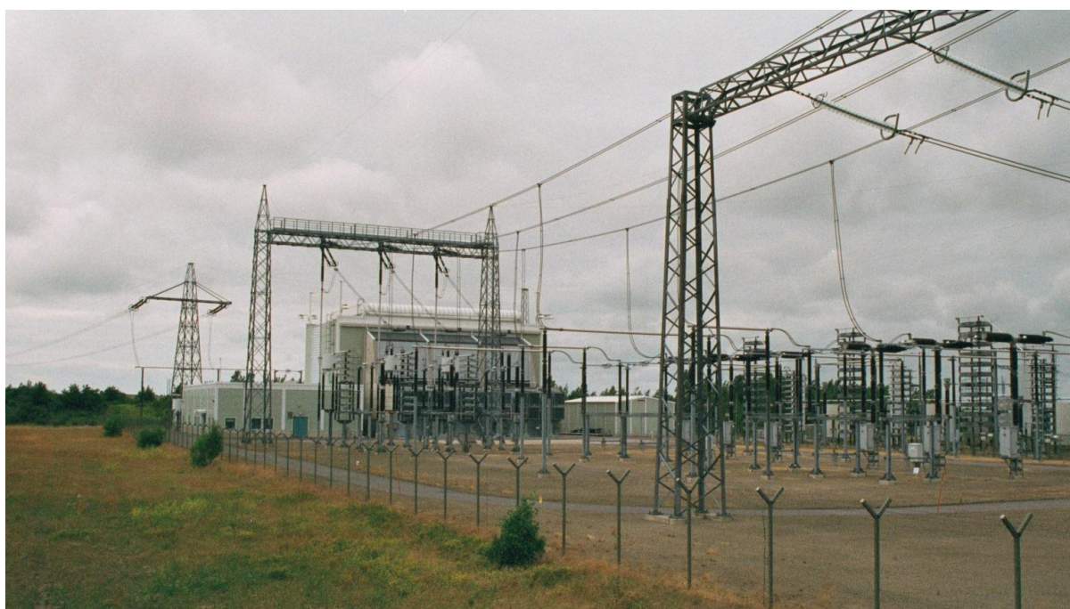
Figur 5: HVDC-station i Kruseberg, Svenska sidan av Baltic Cable (By Timberwind, CC BY-SA 3.0, https://commons.wikimedia.org/w/index.php?curid=14126335 )
