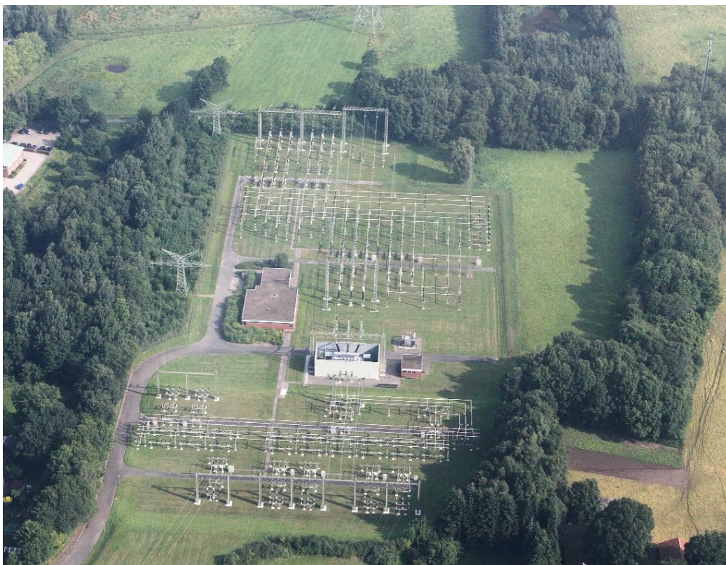
Figur 3: Exempel på HVAC-station med AIS (By Bin im Garten - Own work, CC BY-SA 3.0, https://commons.wikimedia.org/w/index.php?curid=20684264 ).
