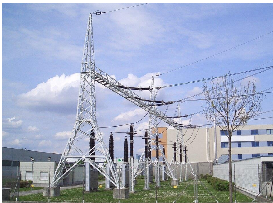
Figur 10: Exempel på terminalstation där luftledning övergår i markkabel (Wdwd, 2020). CC BY-SA 3.0
