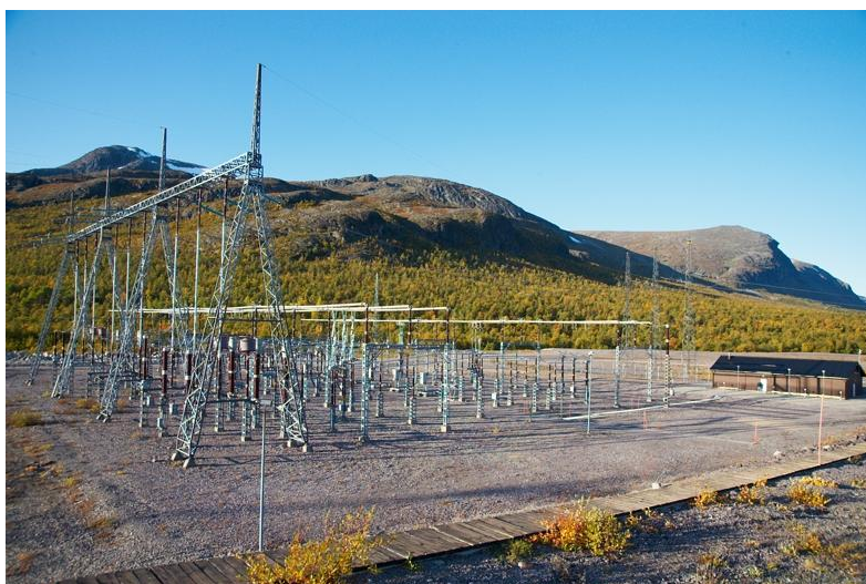
Figur 8: Bild på ett ställverk vid Stora Sjöfallet i Gällivare kommun. I förgrunden syns en grusplan på vilken det finns elektriska komponenter (Foto av Bengt A. Lundberg Riksantikvarieämbetet, 2008). CC BY 2.5.
