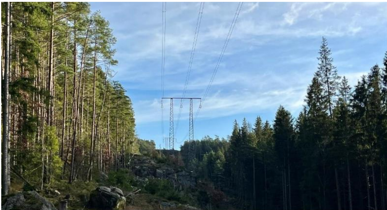
Figur 4: Exempel på kraftledningsgata för luftledning med röjd skogsgatan. Bilden visar en kraftledningsstolpe som bär sex luftledningar. Under ledningen och precis bredvid ledningen finns inga träd (AFRY).
