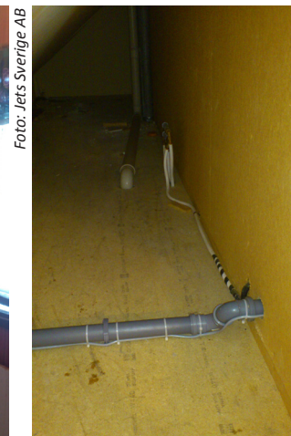
Ledning på vind.
