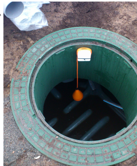
Tank med larmvippa och anslutna ledningar.
