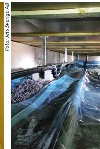
Ledning i krypgrund.
