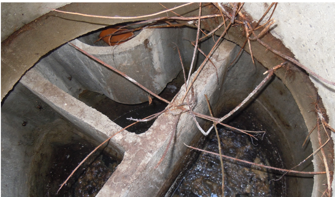
Otät slamavskiljare, risk för in- och utläckage av avloppsvatten och igensättning av efterföljande reningssteg.
