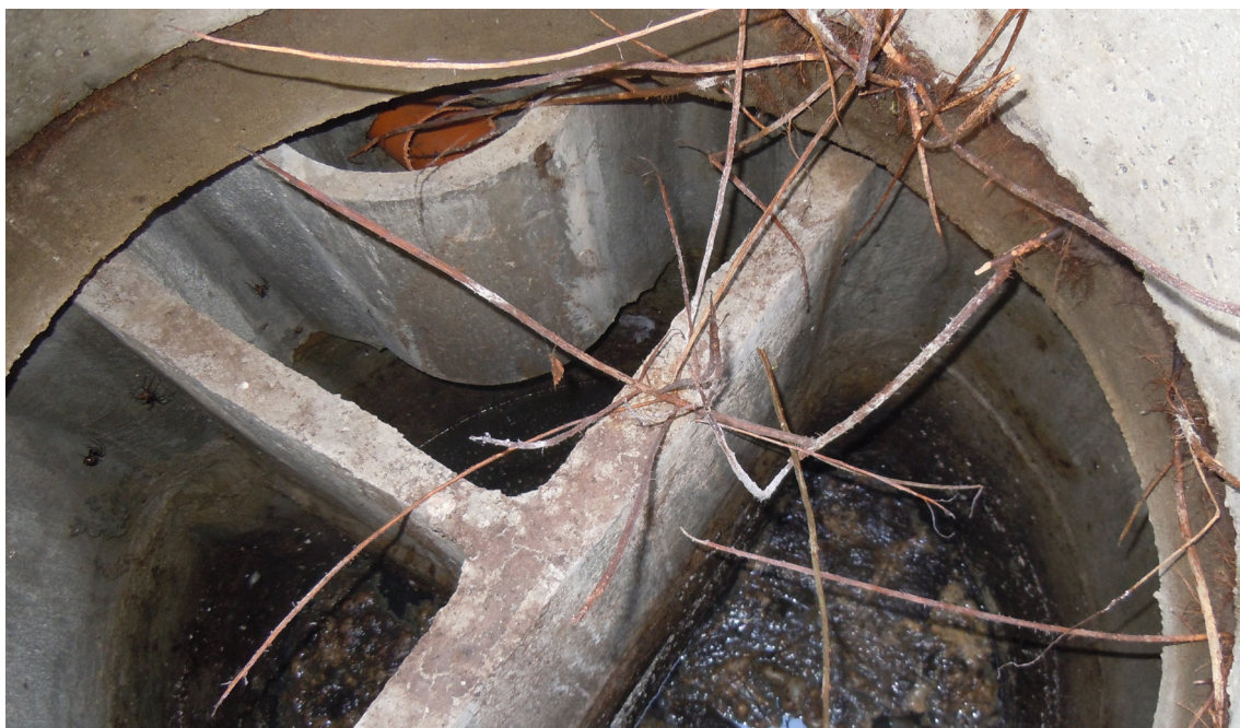
Otät slamavskiljare, risk för in- och utläckage av avloppsvatten och igensättning av efterföljande reningssteg.
