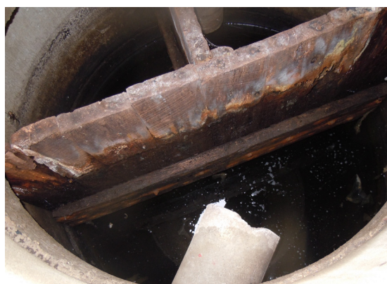
Mellanvägg i trä, risk för slamflykt.
