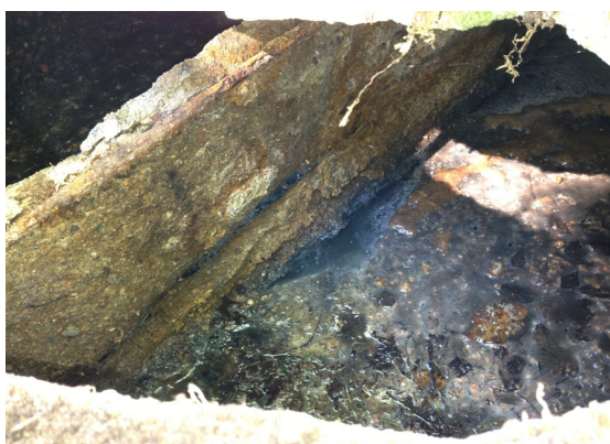
Skadad mellanvägg, risk för slamflykt.
