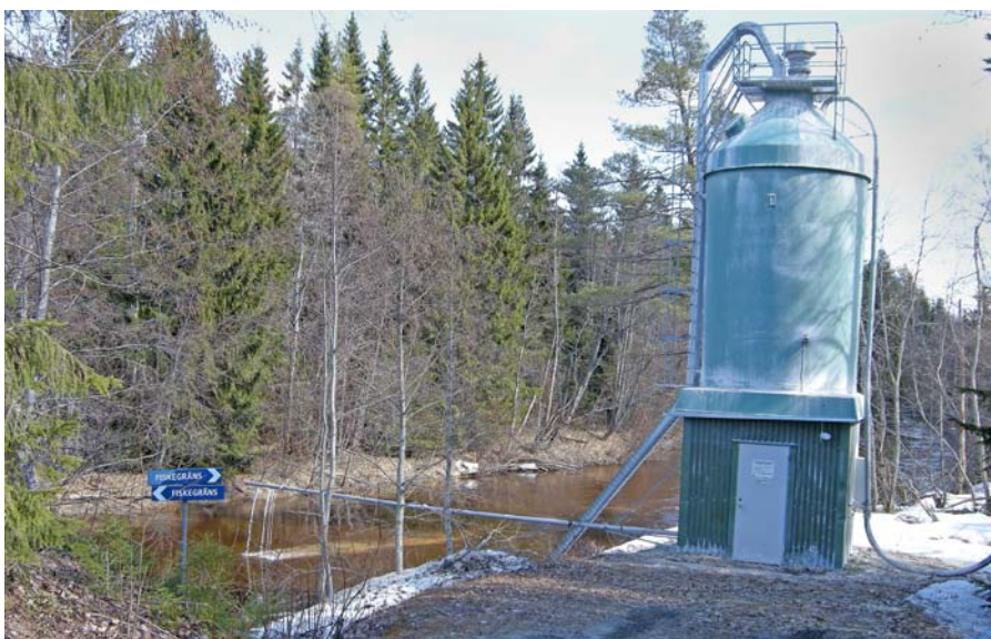
Kalkdoseraren har en silo som vanligen rymmer 40–80 ton. Med ett ekolod registreras vattennivån kontinuerligt. Därmed anpassas den utdoserade kalkmängden automatiskt till vattenflödet. Foto: Mats Norberg.
