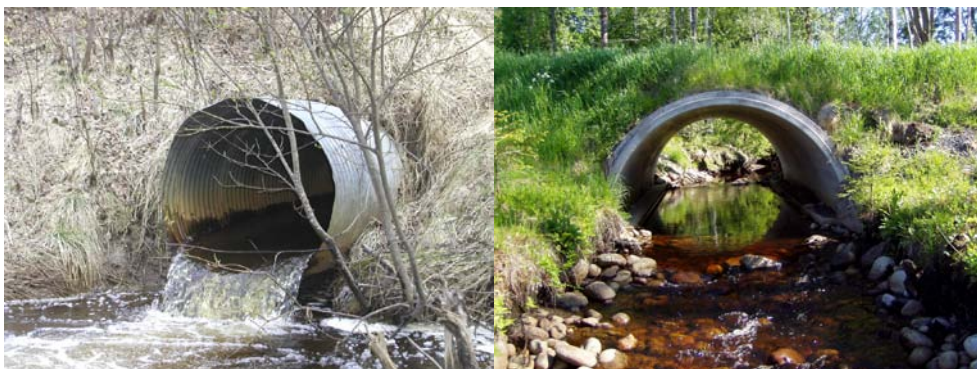
Många dåligt lagda vägtrummor försvårar eller förhindrar för fisk och andra vattenlevande djur att återkomma till ett kalkat vatten (bild till vänster). Med bidraget till biologisk återställning har hundratals vandringshinder åtgärdats (bild till höger). Foto: Mats Norberg.
