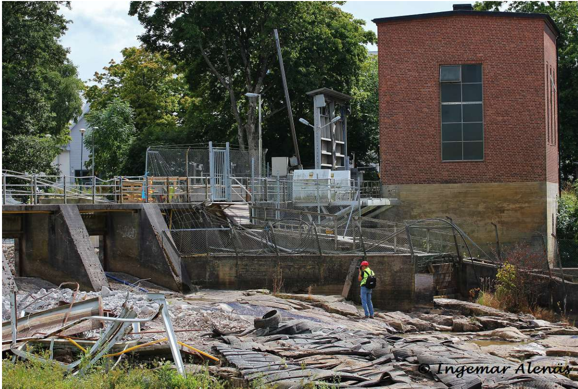
Thomas Andersson/N har följt projektet under hela planerings- och byggfasen. Här dokumenterar Thomas rivningen av kraftverksdammen. © Foto Ingemar Alenäs
