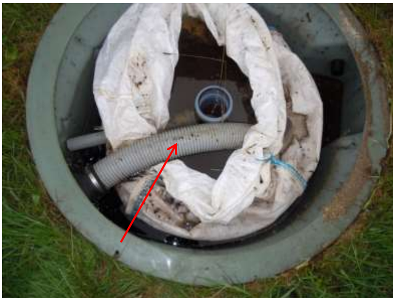
Bild 7 Fosforfälla med "bakfall" på inloppsroret.
