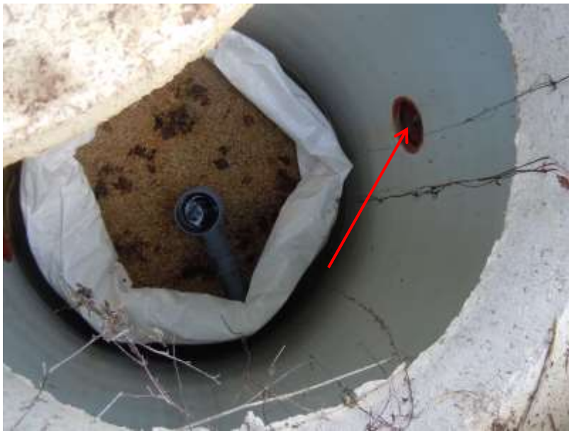
Bild 10 Inloppsrör saknas vilket gör att inget vatten går genom filtret.
