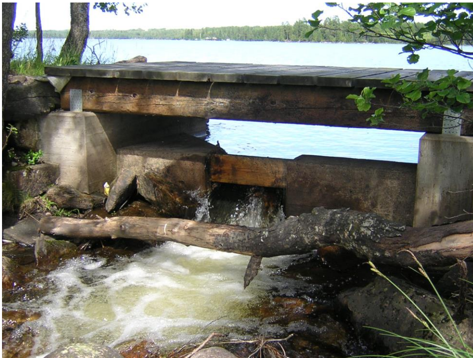
Figur 5. Konstgjort sjöutlopp som håller sjöytan på en jämn nivå. Foto: Länsstyrelsen i Jönköpings län
